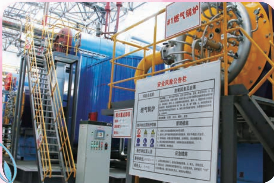
集團鼓勵客戶將鍋爐升級，轉用天然氣產能，以配合國家推動的環保政策。位於山東省濟南南郊熱電廠的五台鍋爐已改以燃氣驅動，年用氣量超過3,000萬立方米。
