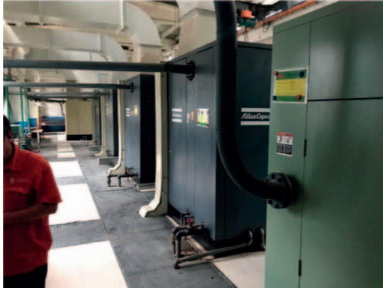
圖 16-6. 焦家礦區地面壓縮機房及工作壓縮機
