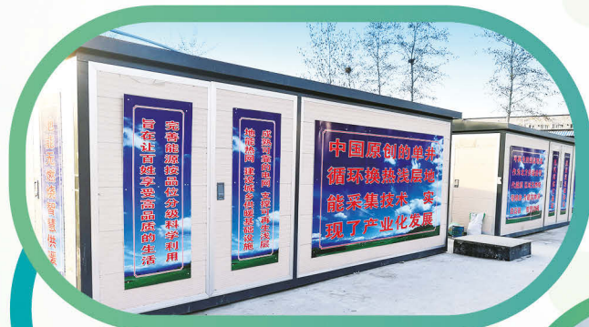
高效電替煤集中供暖機房
