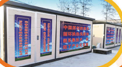
高效電替煤集中供暖機房
