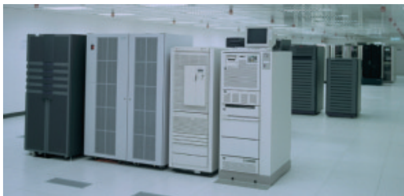
ASL Data Center
