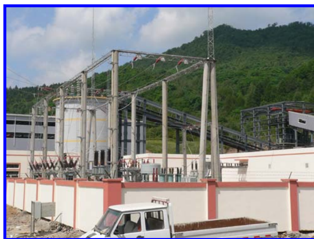
白山礦變電站（目前已與系統電網聯接）
