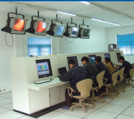
山東聯合王冕中央控制室 Central Control Room of Allied Wangchao
