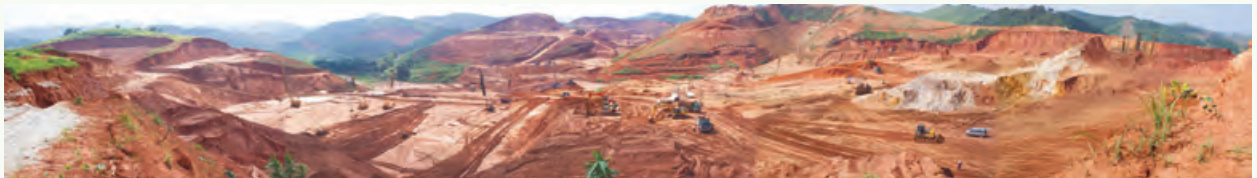
本公司位於廣東封開在建中的最大水泥生產基地部份 A portion of the Company's largest cement production plant under construction in Fengkai, Guangdong
