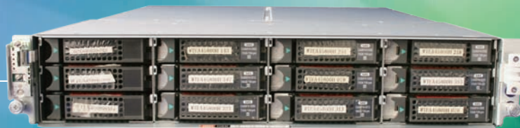
Storage System for Mainframe Computer 電腦主機儲存系統
