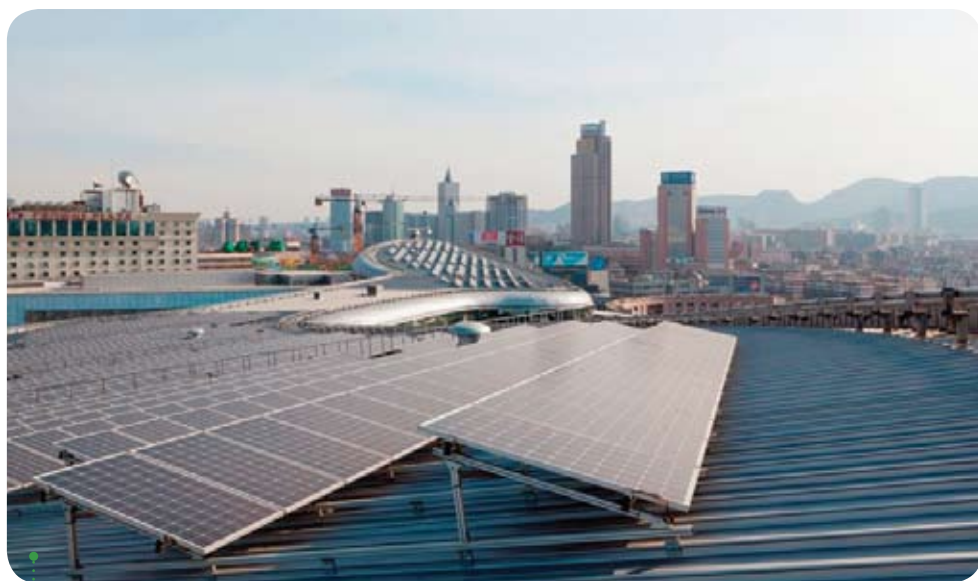
濟南恒隆廣場的光伏面板 Photovoltaic panels at Parc 66
