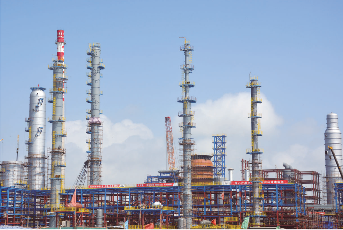
甲醇制烯烴生產設施全景(於二零一四年八月中)
