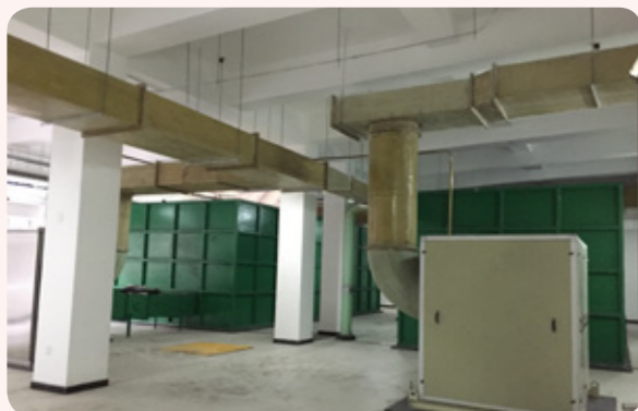
多級多段除臭系統
