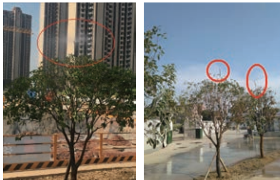
湖南芙蓉3.1期施工現場道路兩側綠植噴淋的應用實踐照片
