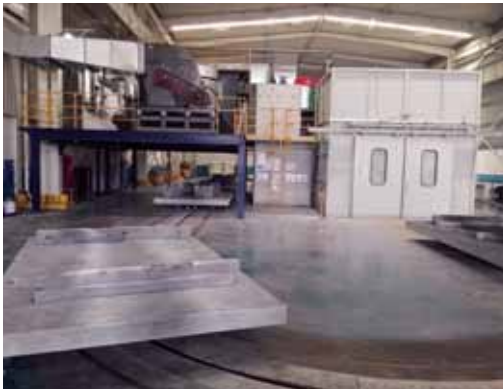
位於中國寧波其中一個廠區的噴漆房及廢氣處理設施
