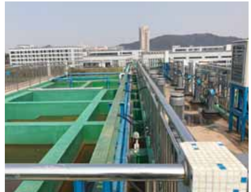
圖中是位於中國寧波其中一個廠區的污水處理設施
