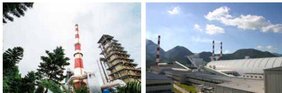
福清浮法除塵脫硝和餘熱發電設施
