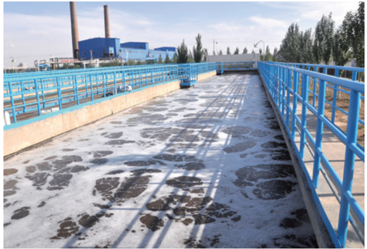
廢水處理設施
