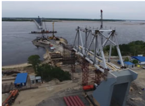
俄方段的阿穆爾河大橋正在安裝首個橋段， 施工進度良好
