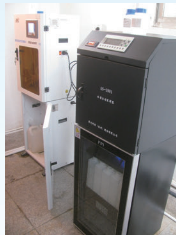
廢水處理監控系統
