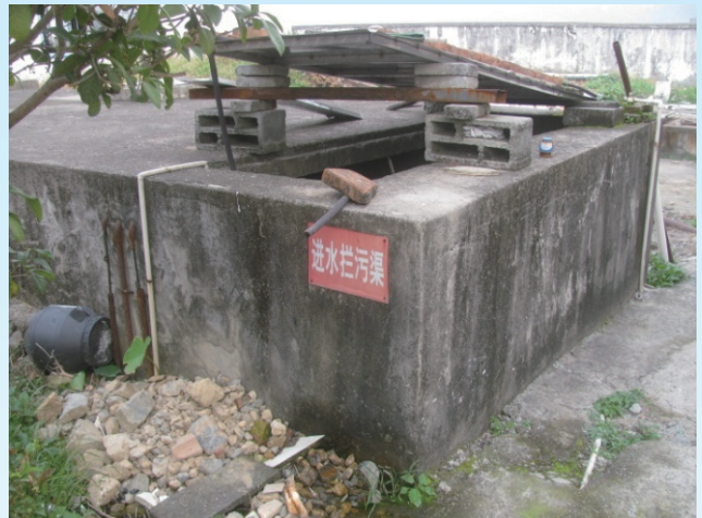
廢水過濾及處理系統
