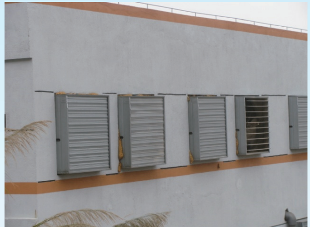
養豬欄排氣扇
