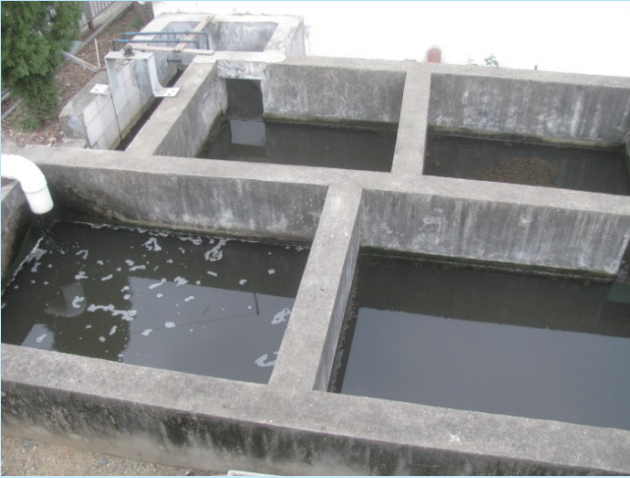
廢水過濾及處理系統
