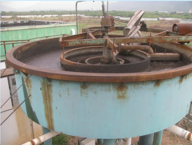
廢水過濾及處理系統
