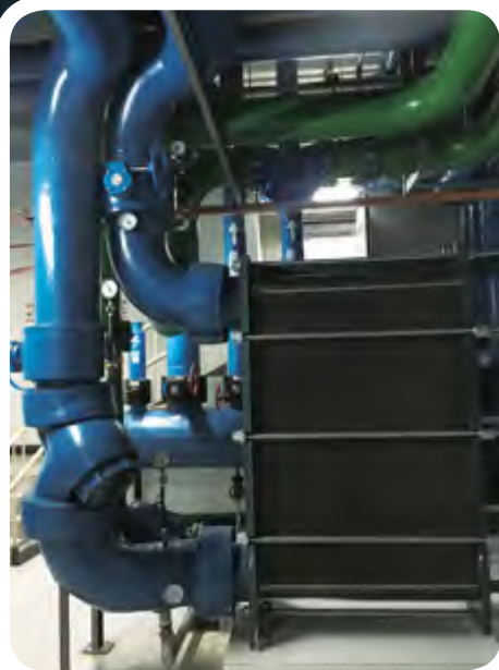
冷却水再利用设备
