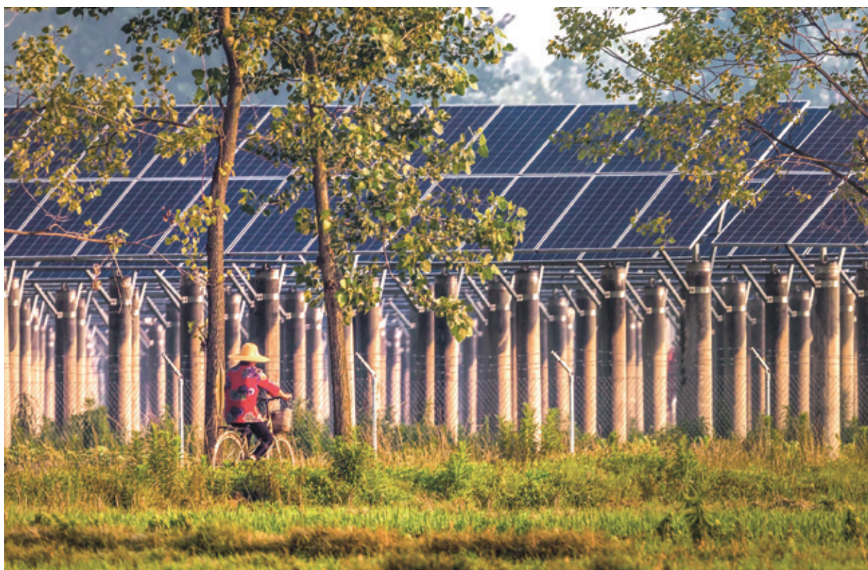
位於安徽省阜南縣的117兆瓦光伏扶貧電站
