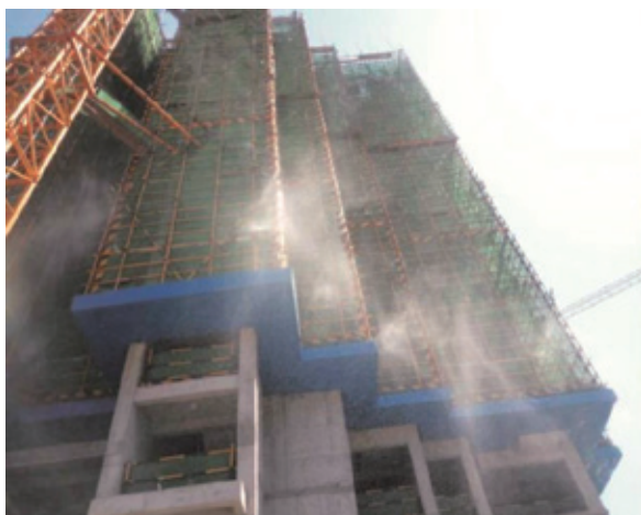
圖9：施工現場外架噴淋系統
