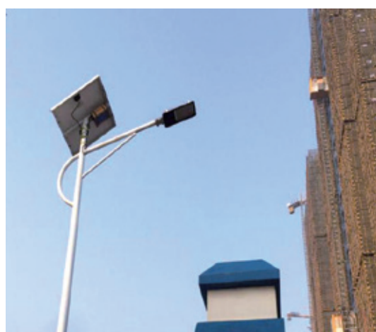
圖10：施工現場太陽能路燈
