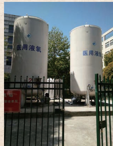
醫院液氧儲罐
