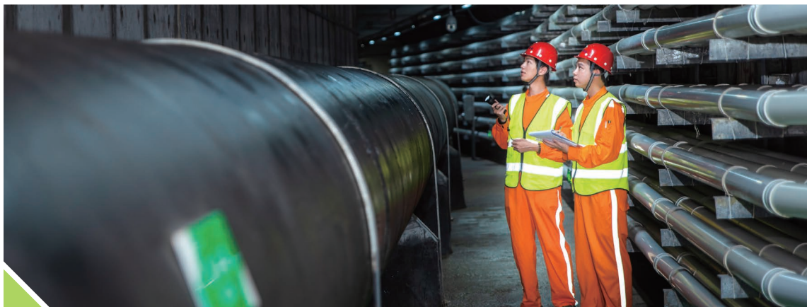
橫琴島地下綜合管道長廊長達33.4公里。圖為工作人員在橫琴綜合管道長廊日常巡檢
