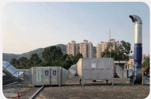
Exhaust air treatment system 廢氣處理系統
