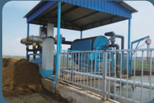
堆肥場固液分離系統
