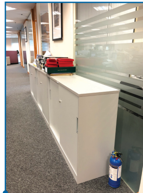
Fire Extinguisher 滅火器
