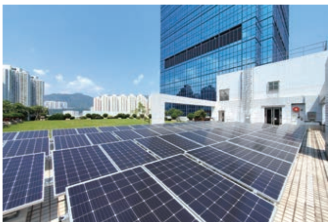
物業管理團隊致力提升能源效益及支持可再生能源，於旗下管理的物業安裝太陽能光伏系統。
