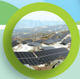
貴州省貞豐二期光伏項目
