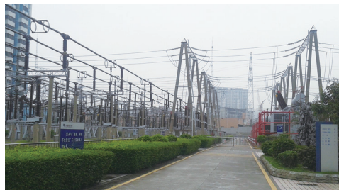
廣州供電局 Guangzhou Power Supply Bureau
