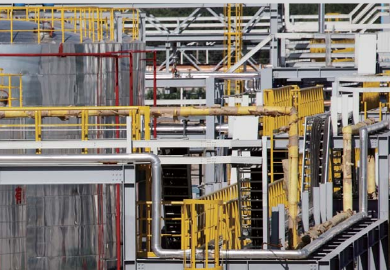
■ CNOOC Tianye POM plant
