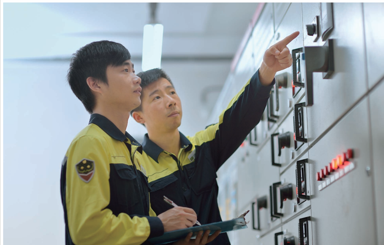
萬物雲——社區空間機房維修檢查
