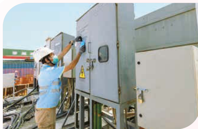
港燈使用安裝於防水電箱中的低壓電纜，為建築工地提供可靠電力供應，減少柴油發電機排放造成的污染。
