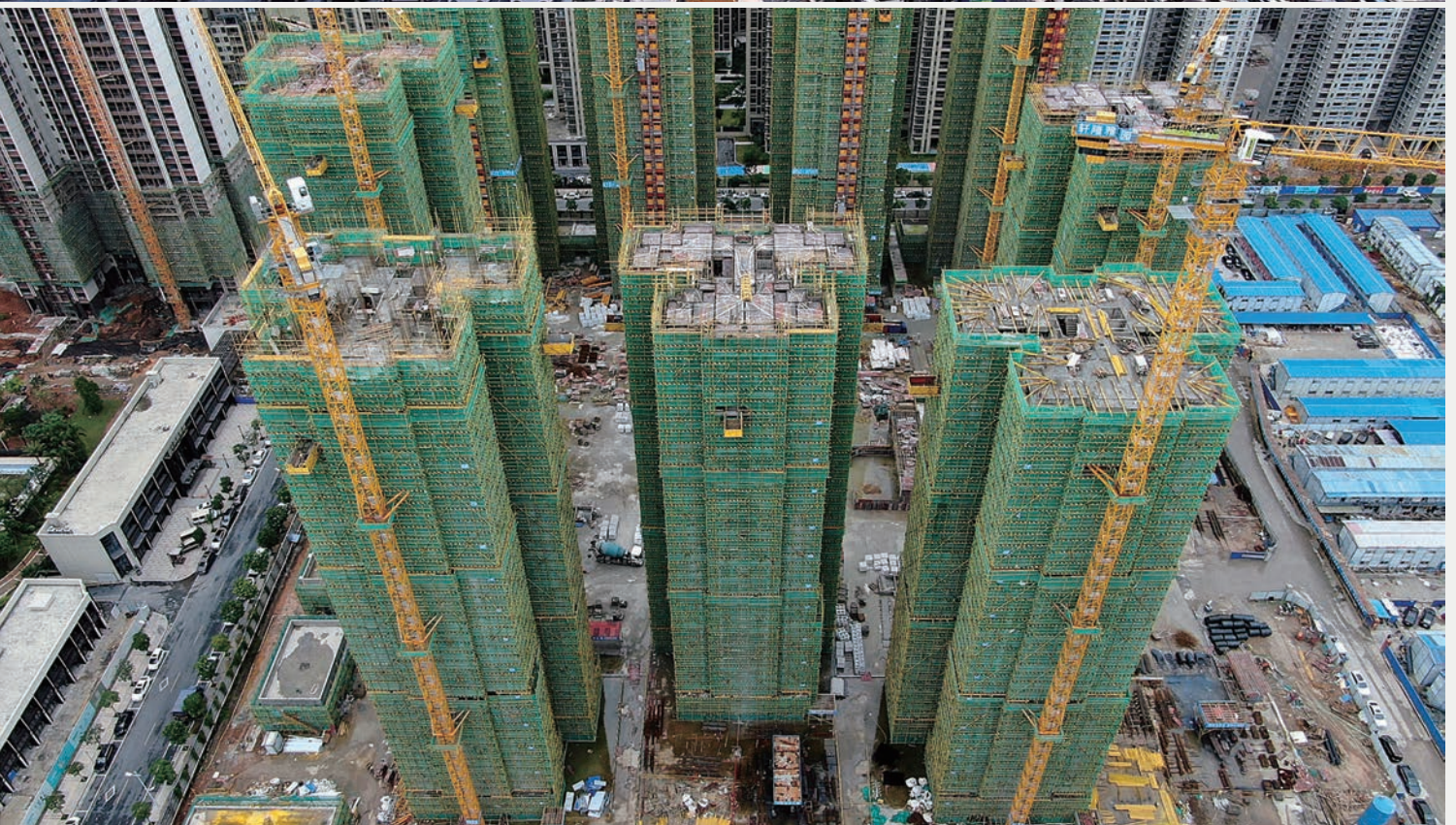
Elegance Garden, Sanshui, Foshan construction in progress 佛山三水軒隆雅園工程進行中
