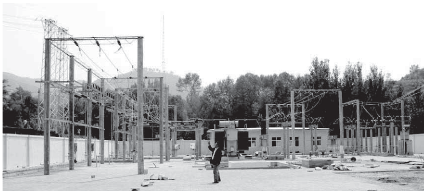
圖12-1：新建葛門溝35 kV變電站
