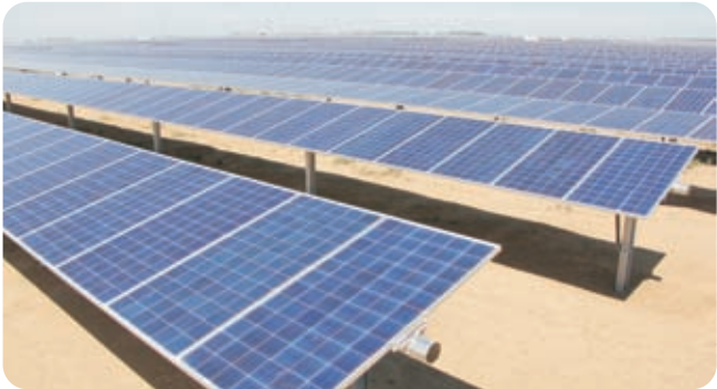
美国108mw太阳能发电厂
