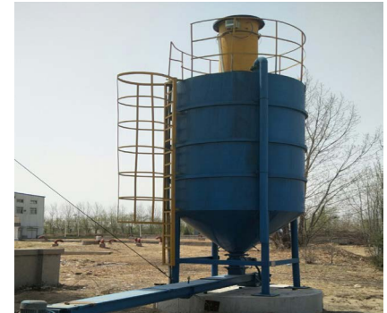
鍋爐大氣除塵脫硫系統
