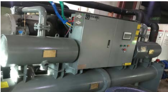
口服液車間雙機頭螺桿冷水機組
