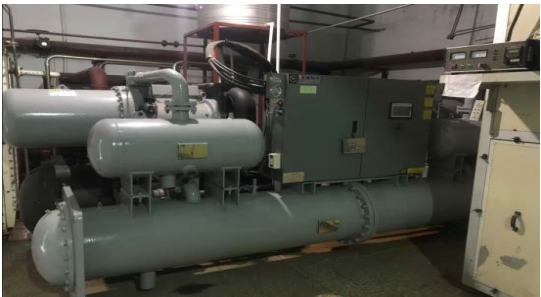
固體車間雙機頭螺桿冷水機組
