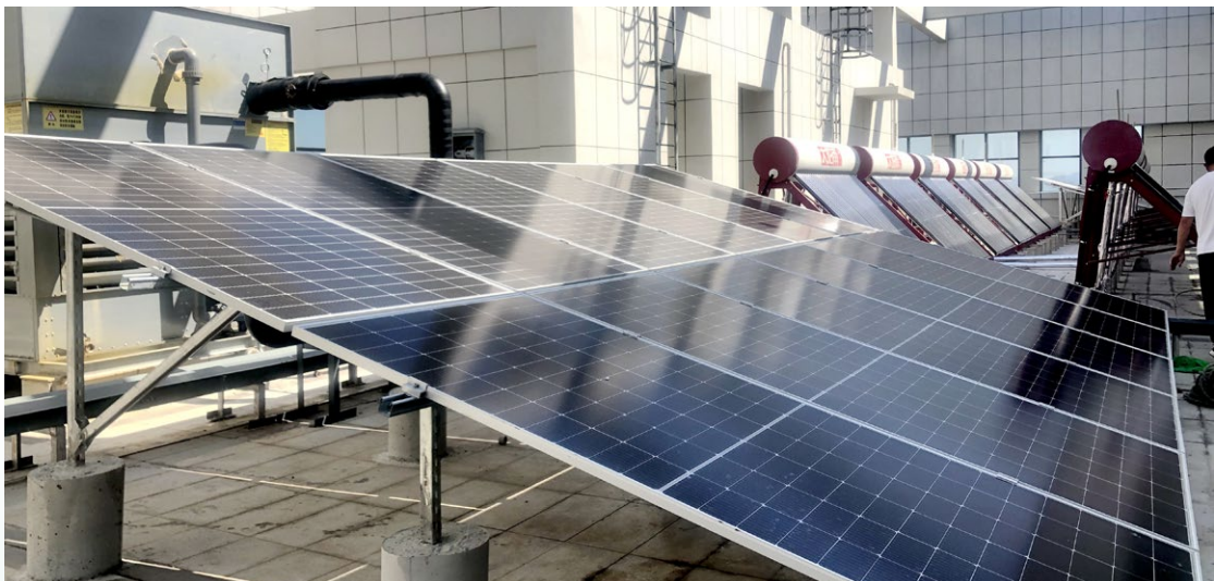
光伏發電裝置 PV power plant
