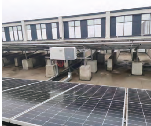
蘇南智城常州智創園高層的光伏設備
