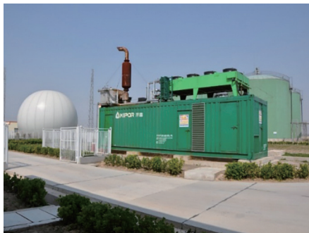
家佳康沼氣發電設施
