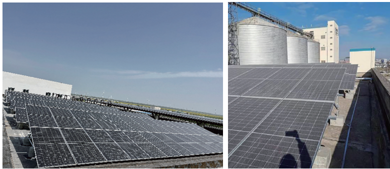
廠區屋頂新增的光伏發電板
