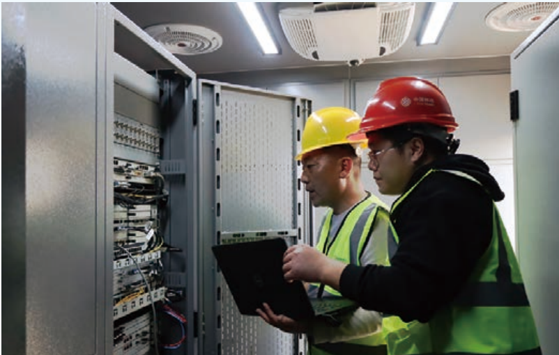
工作人員進行智慧城市設備維護
