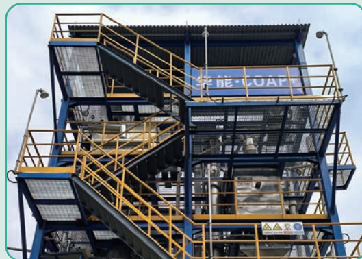
華能岳陽燃煤煙氣二氧化碳捕集中試裝置
