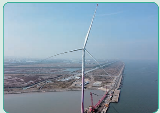
華能天津港50兆瓦風電項目
