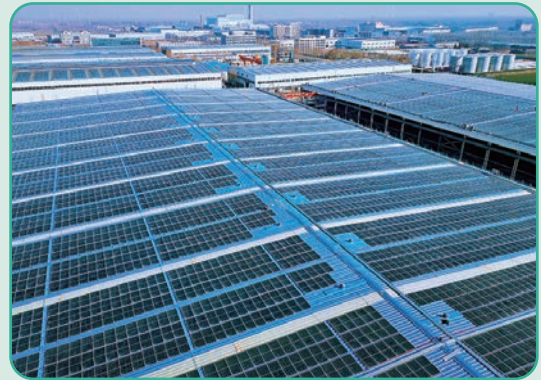
華能河南延津屋頂分佈式光伏項目
