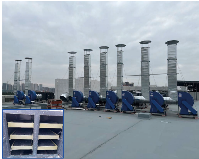
TC-廢氣處理設施
