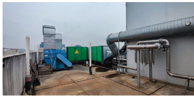
GD-廢氣處理設施
