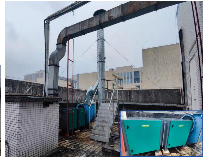
HN-廢氣處理設施
