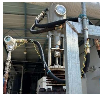
蒸汽壓力自動調節裝置
