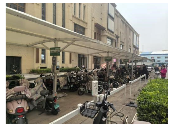
河北省滄州市政項目電動車充電樁
