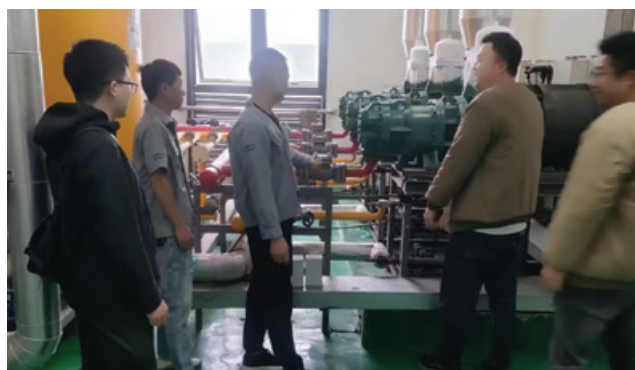
冷庫機房設備培訓
