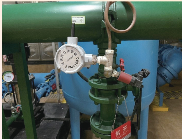
智慧機房－水泵房水壓傳感器
