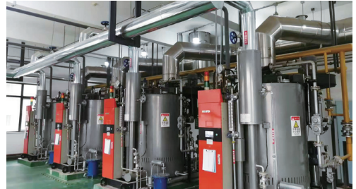
北京工廠燃氣鍋爐採用低氮燃燒器
