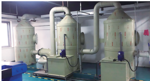
北京工廠污水處理系統採用廢氣無害化處理方式
