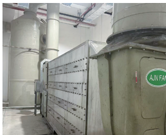
上海污水站廢氣處理設施
