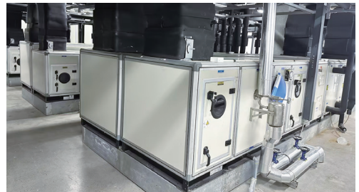
上海實驗室排風處理機組
