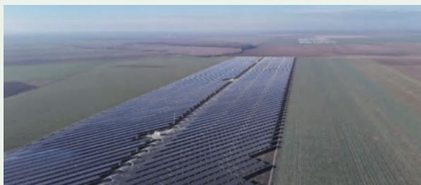
上海電氣斯庫爾圖光伏項目
