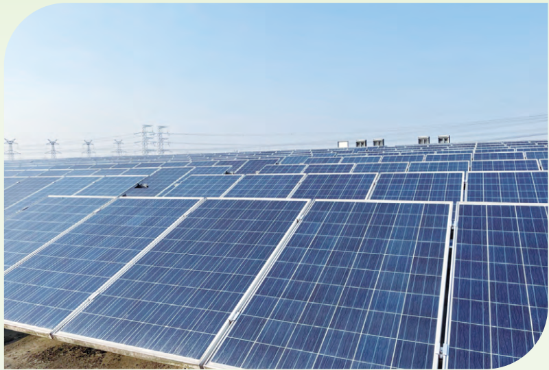
九陽光伏發電設備
