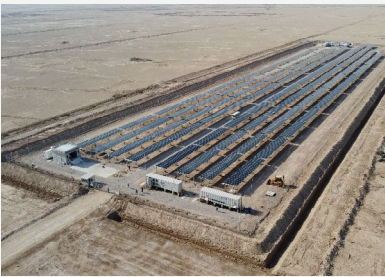
伊拉克九區的離網光伏儲能電站
