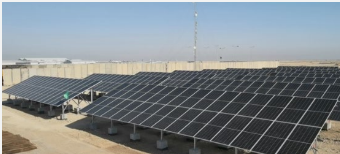
伊拉克九區大慶營地太陽能電站
